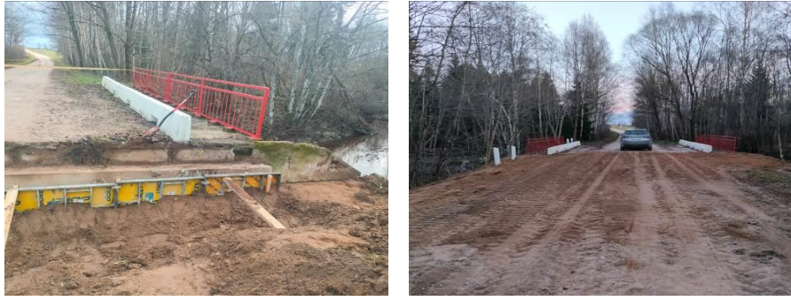
8 pav. tilto per Sausdravo upę Glaudžių k., Klevų g. remonto darbai (po)
